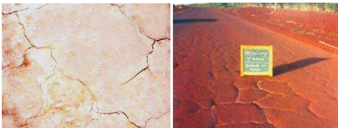
Figura 7: Solo laterítico em processo de trincamento por “cura ao ar”
