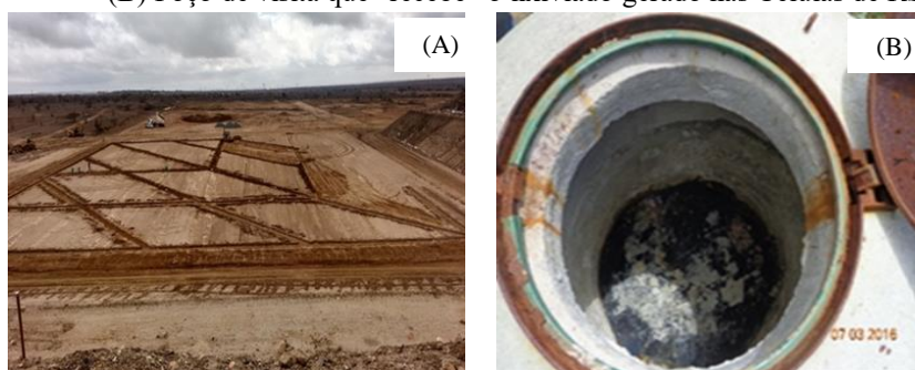
Figura 13 - Sistema de drenagem e coleta do lixiviado gerado. (A) Sistema do Tipo “Espinha de peixe”; (B) Poço de visita que “recebe” o lixiviado gerado nas Células de RSU
