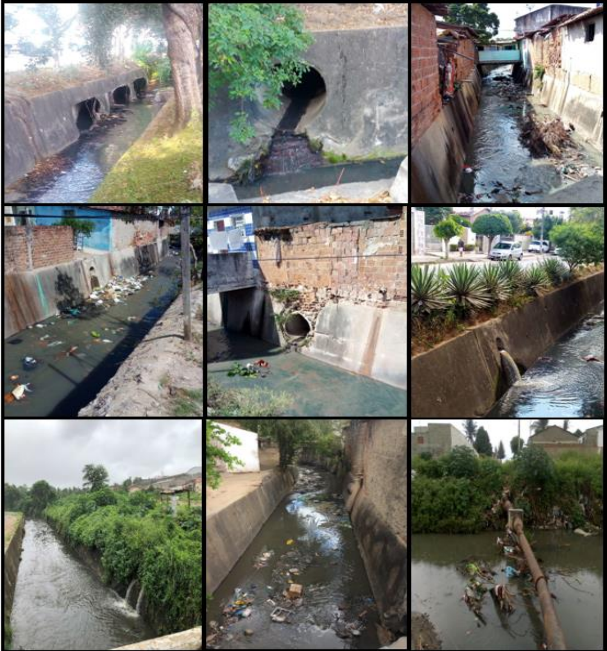
Figura 27 - Não conformidades observadas nos canais da bacia do Riacho do Prado
