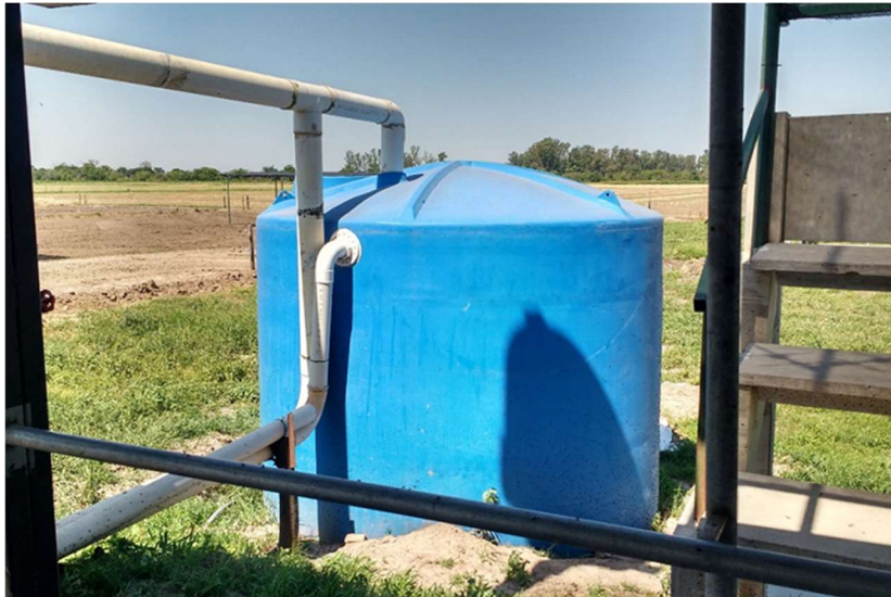
Figura 5 - Cisterna de Polietileno
