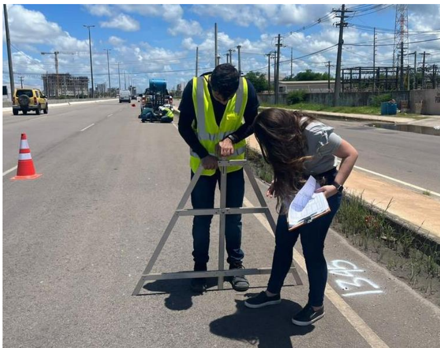
Figura 24 - Medição do afundamento em trilha de roda conforme o DNIT 433/2021-PRO
