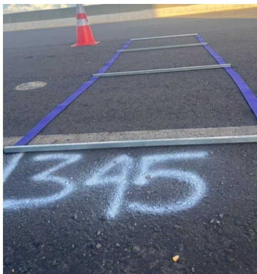
Figura 23 - Medição da área trincada conforme DNIT 433/2021-PRO
