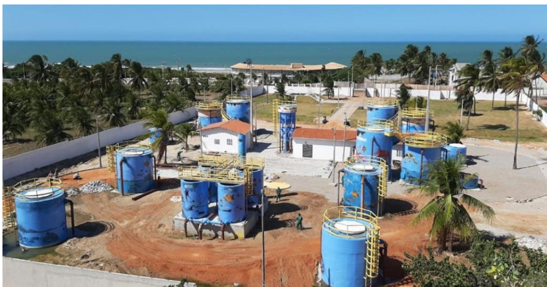
Figura 5 - Estação de tratamento de esgoto de Flecheiras/CE.
