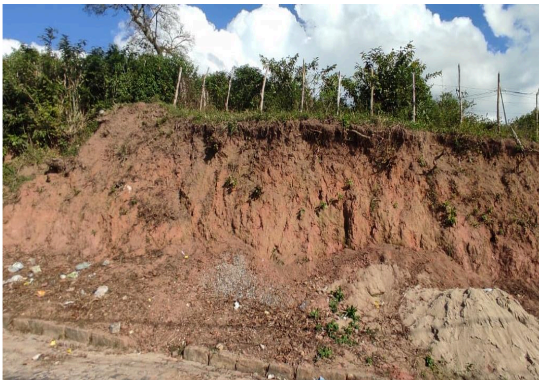
Figura 9 - Área onde ocorreu um movimento de massa na Rua João Lourenço
