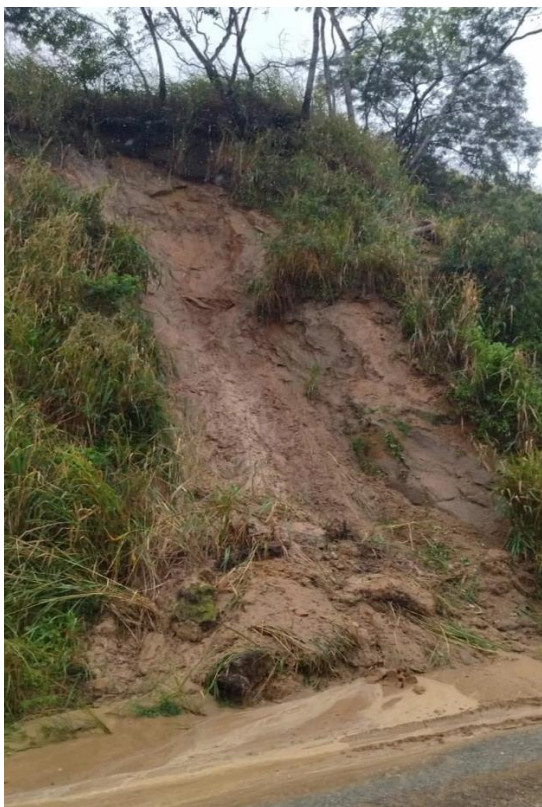
Figura 32 – Movimento de massa próximo a estradas no município de Areia (PB)
