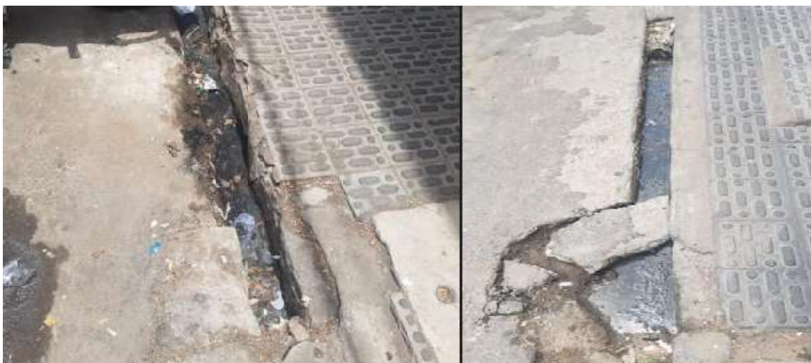
Figura 15: Ausência de esgotamento sanitário, bairro João Cabral
