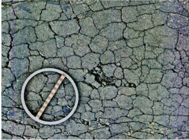
Figura 3. Dano por fadiga.
