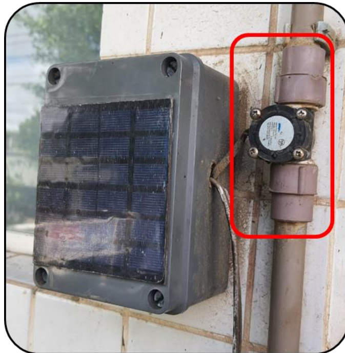
Figura 20 - Sensor de fluxo instalado na tubulação
