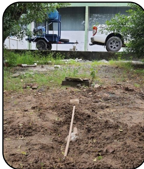
Figura 41 - Dia 11/07/2022 após conserto do vazamento
