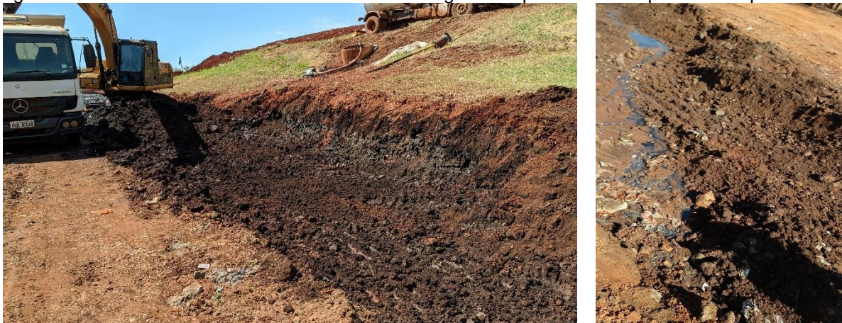
Figura 22 – Vazamento de lixiviado observado ao longo do mapeamento dos processos operacionais
