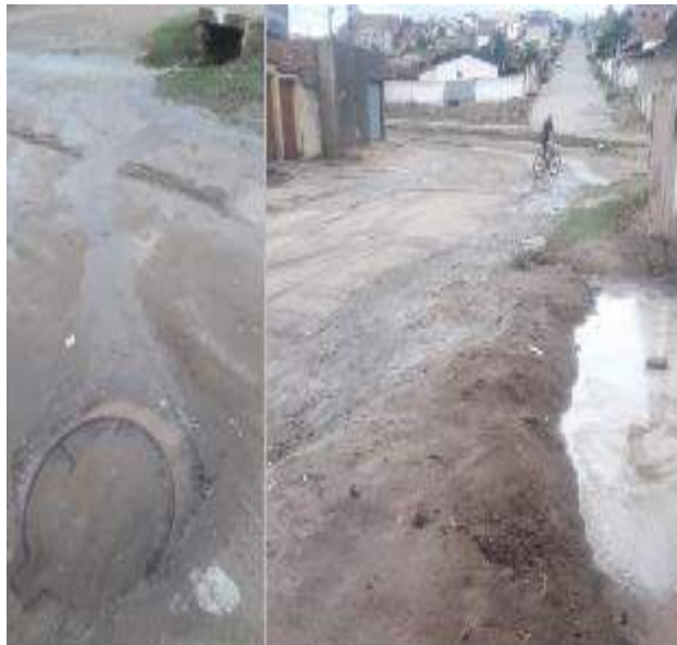
Figura 23: Extravasamento de poços de visita e alagamentos na rua Luiz Mota 27/02/21
