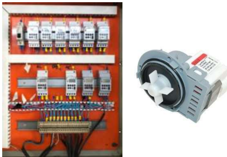
Figura 8 – Acessórios utilizados no sistema de descarga e alimentação das lagoas de Transbordo, painel de controle com os temporizadores industriais e na sequência a eletrobomba universal.
