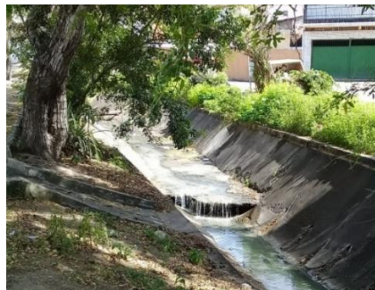
Figura 35 — Desnível na calha do Riacho das Piabas
