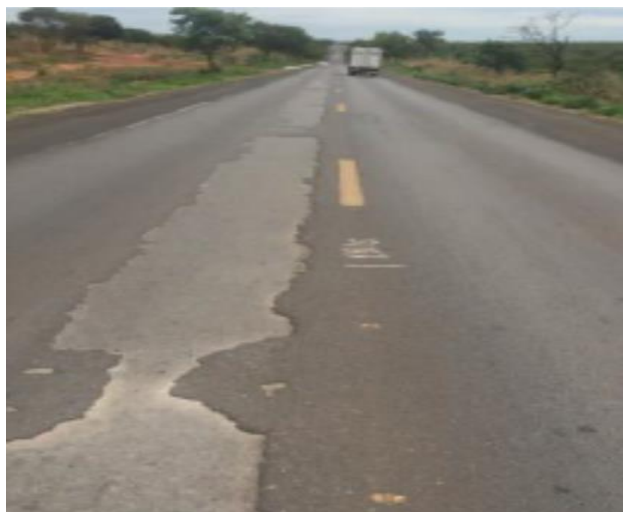
Figura 6 - Desagregação/Desgaste do revestimento
