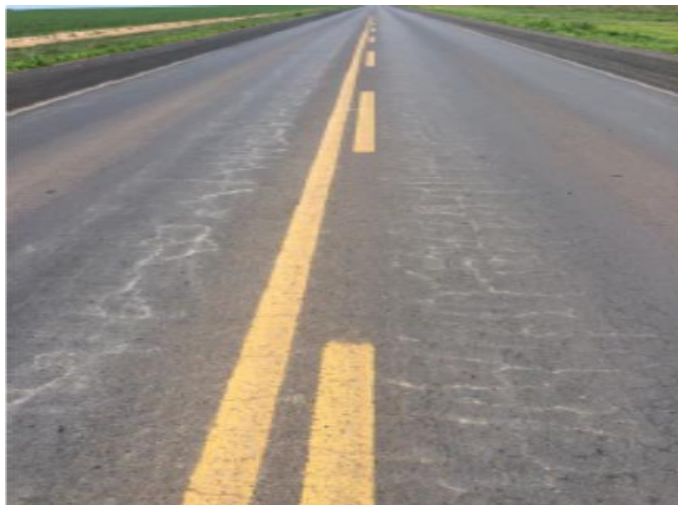
Figura 4 - Trincas e fissuras em revestimento asfáltico
