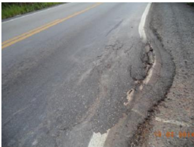
Figura 5 - Escorregamento do revestimento asfáltico
