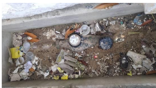
Hidrômetro do CCT
