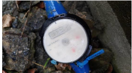
Hidrômetro da UAMA (h)
