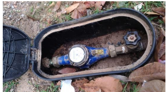
Hidrômetro do EAD (j)
