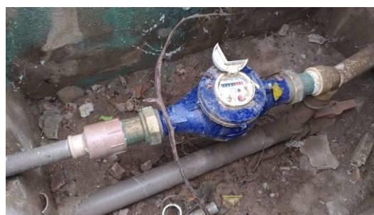
Hidrômetro do CCBS – Entrada Principal
