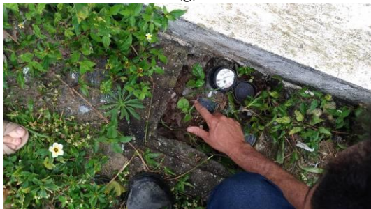
Hidrômetro da PROINFRA (i)
