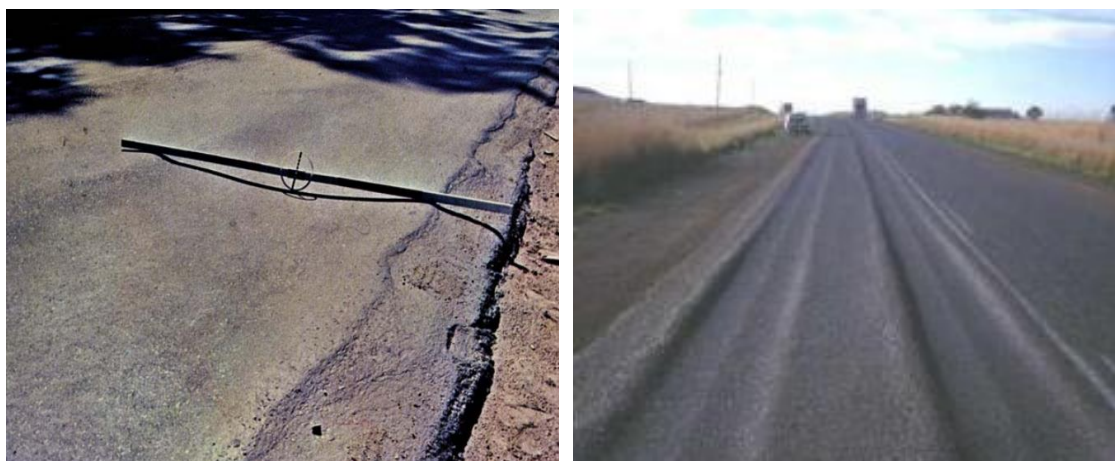
Figura 3 – Afundamento de trilha de roda.
