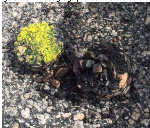
Figura 43 – Desagregação da mistura asfáltica.
