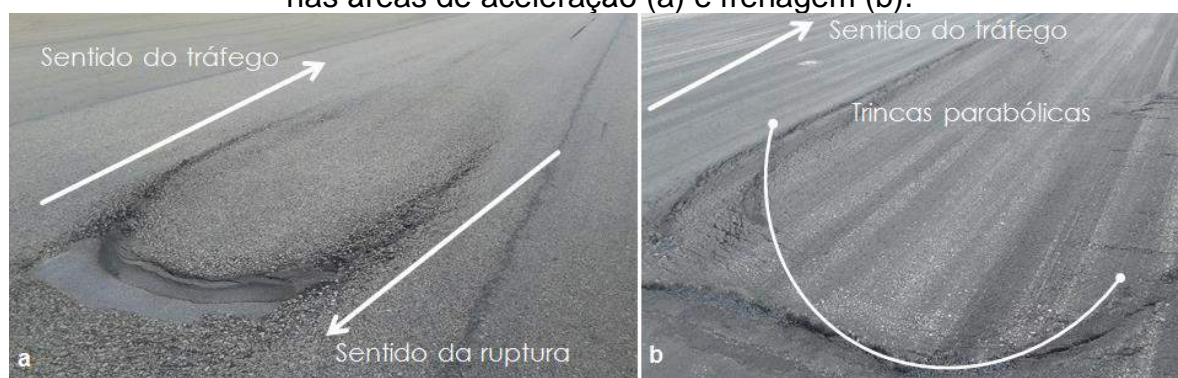
Figura 7 – Escorregamento do revestimento asfáltico do pavimento aeroportuário nas áreas de aceleração (a) e frenagem (b).
