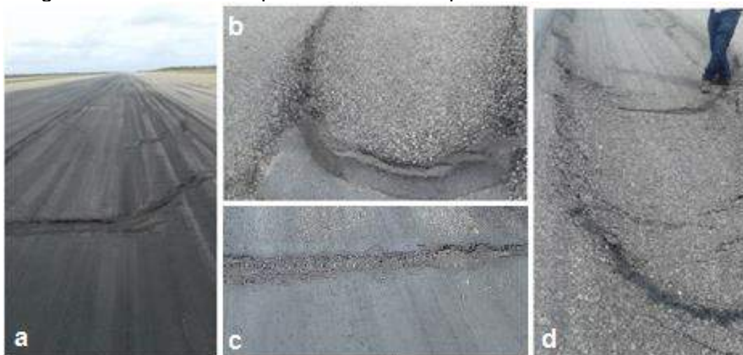
Figura 41 – Defeitos no pavimento do Aeroporto Internacional de Natal.
