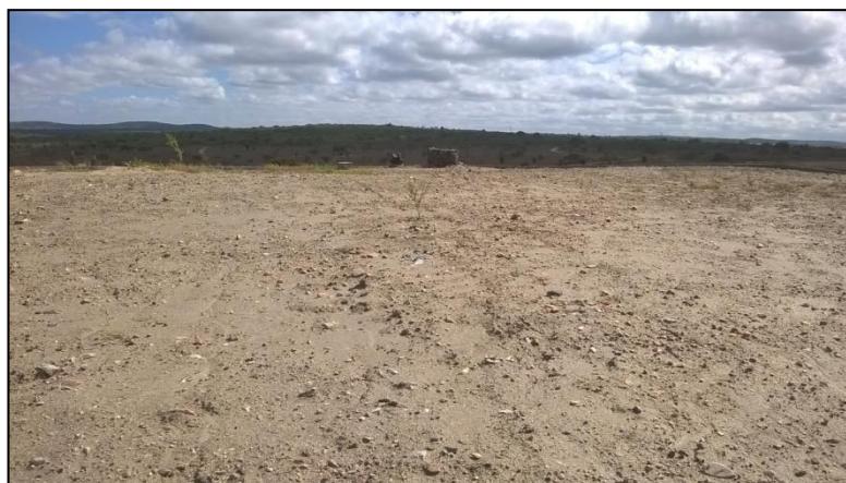
Figura 55 - Inexistência de vegetação para proteção superficial.
