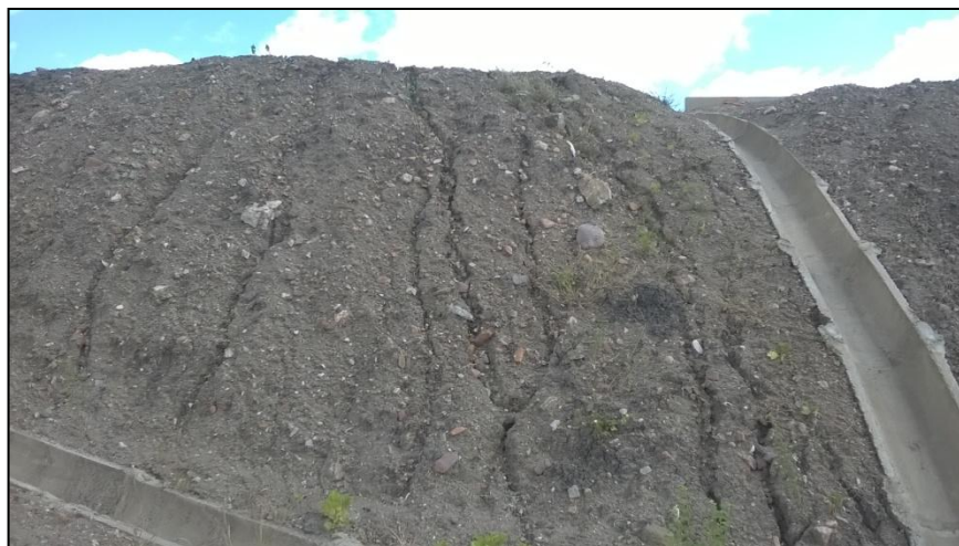
Figura 57 - Erosão do solo.
