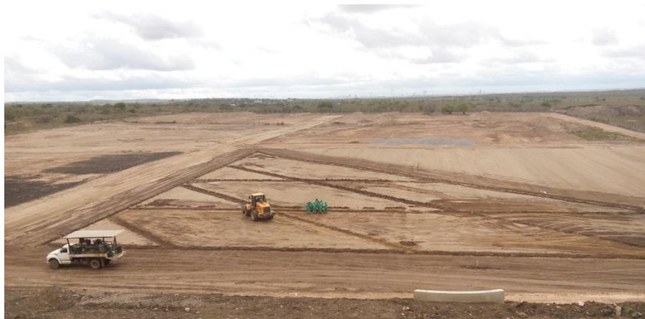
Figura 10 – Execução de camada de base do Aterro Sanitário de Campina Grande (PB)
