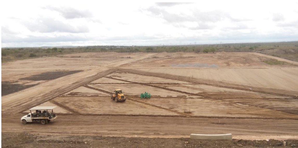
Figura 6 – Execução de camada de base do Aterro Sanitário de Campina Grande (PB)
