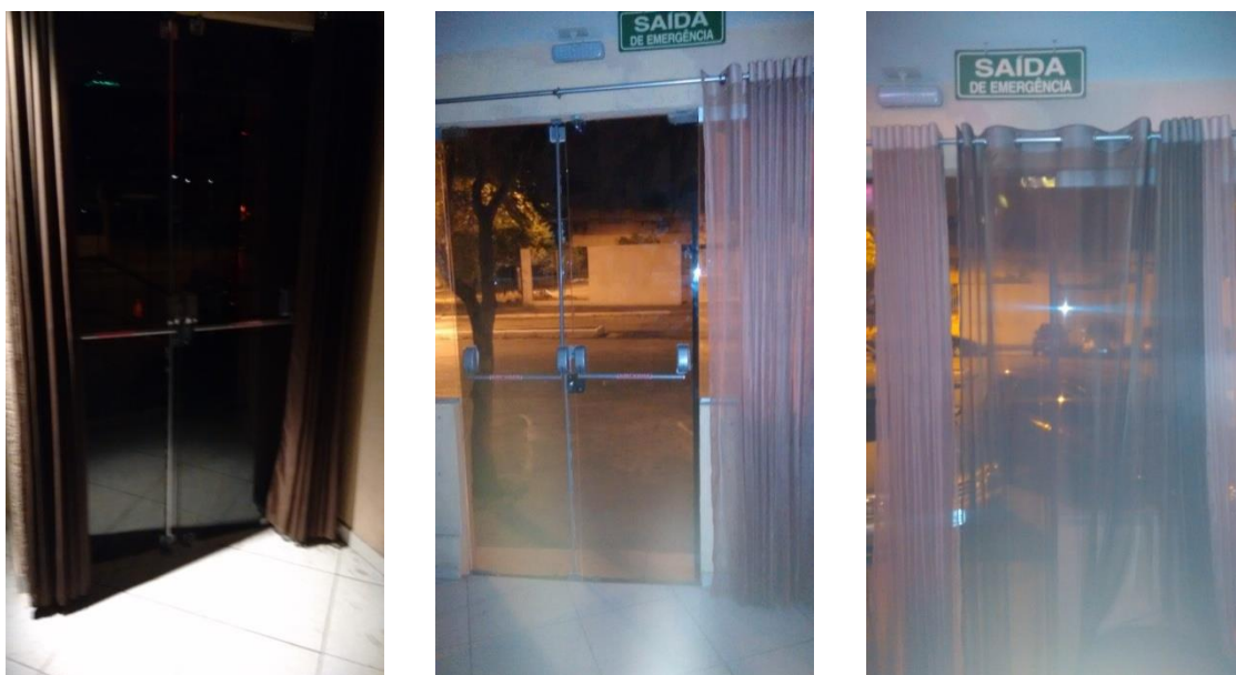
Figura 33: Imagens das portas de emergência da edificação B.
