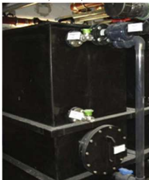
Figura 6 – Tanques pressurizados de urina na sede da GTZ, Eschborn, Alemanha.
