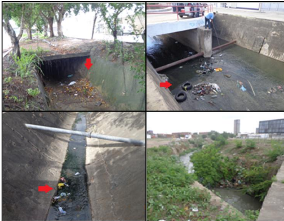
Figuras 5.1 - Componentes do sistema de drenagem pluvial de Campina Grande - PB.
