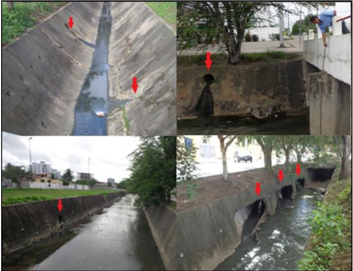
Figura 5.4 - Lançamento de efluentes ao sistema de drenagem pluvial.
