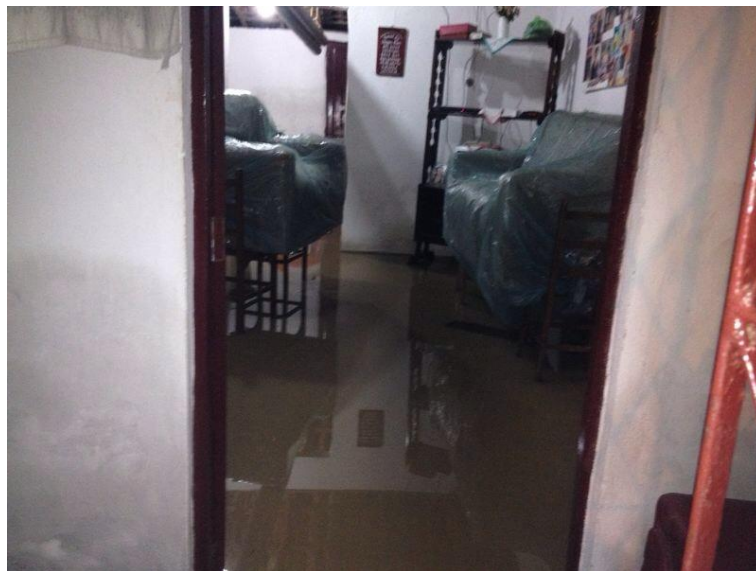
Figura 31 - Interior de residência após episódio de chuva
