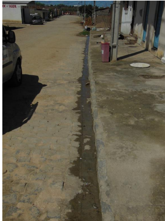
Figura 30 - Presença de esgoto na sarjeta
