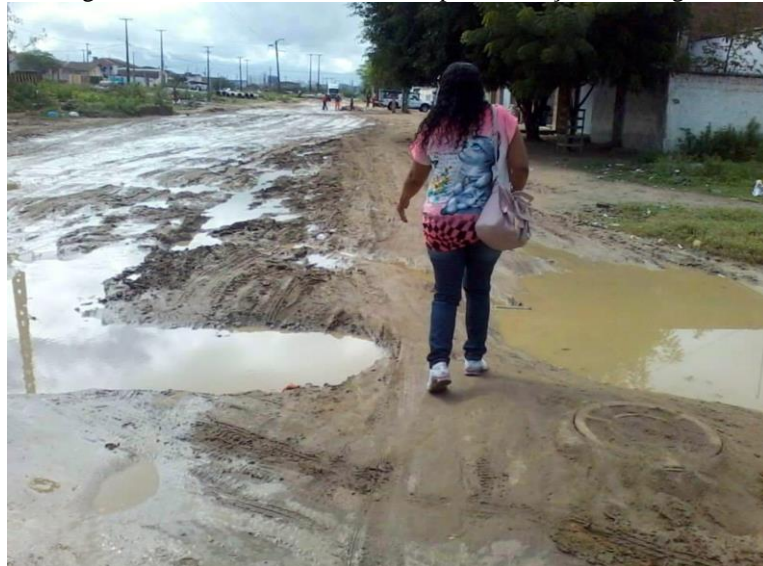
Figura 38 - Avenida de acesso sem pavimentação e drenagem
