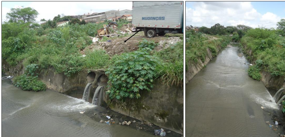
Figura 12 - Aterro lançado nas proximidades do canal e a vegetação invasora do seu leito
