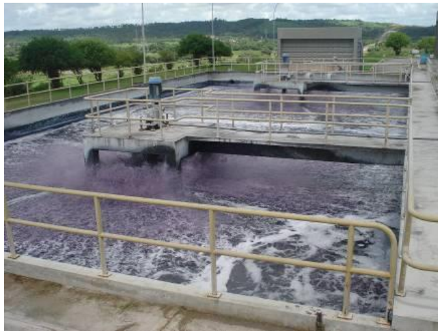
Figura 7 - Estação de Tratamento de Efluentes
