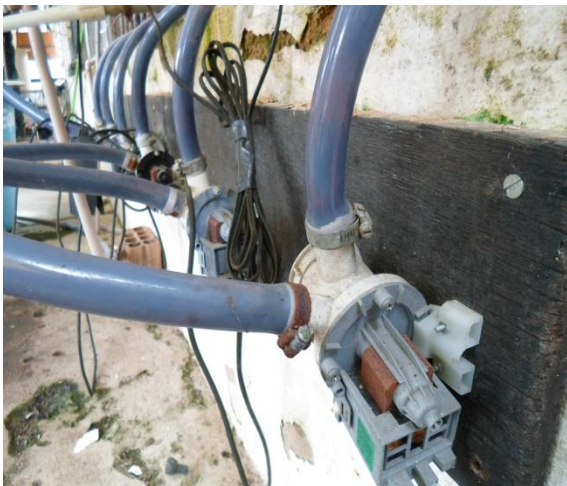
Figura 3.2: Bomba de drenagem utilizada para alimentação dos RBS's
