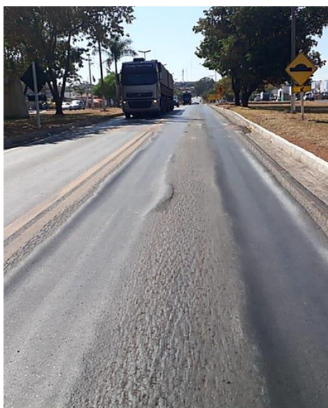
Figura 17: Deformação longitudinal na trilha de roda (deformação permanente)
