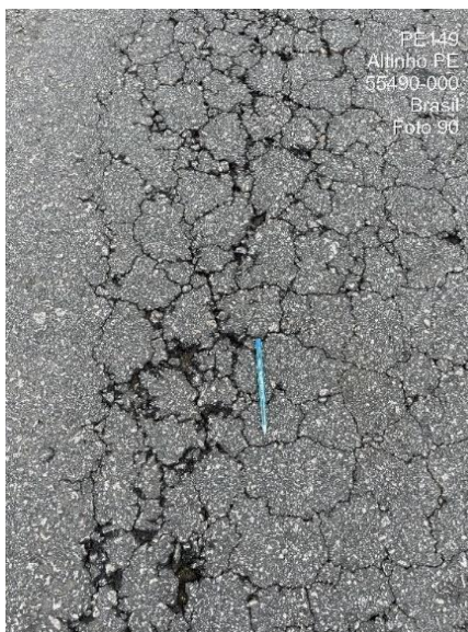
Figura 16: Trinca/Fadiga em pavimento asfáltico
